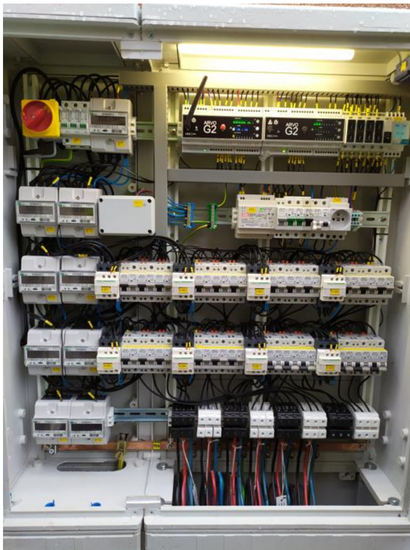
Obrázek 1.12: Rozvaděč veřejného osvětlení (zapínací místo) s řídicí jednotkou pro vzdálenou komunikaci a monitoring obvodových veličin (fotoarchív autora)
